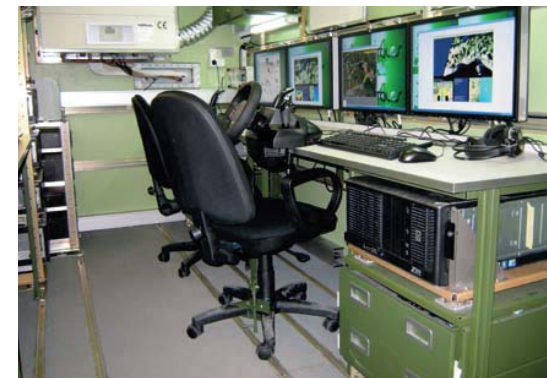
ΜΕΤΑΦΕΡΟΜΕΝΟ ΚΕΝΤΡΟ ΔΙΟΙΚΗΣΗΣ ΚΑΙ ΕΛΕΓΧΟΥ ΕΠΙΤΗΡΗΣΗΣ ΣΥΝΟΡΩΝ - TALOS TRANSPORTANT COMMAND AND CONTROL CENTER FOR LAND BORDER SURVEILLANCE - TALOS
