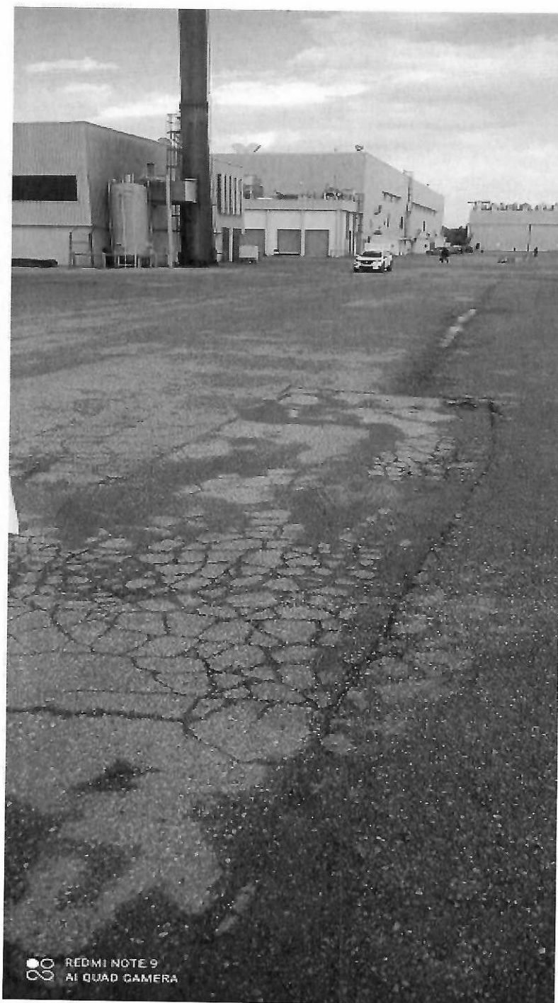
2. Ρωγμές τύπου αλιγάτορα και κατά μήκος ρωγμές.
